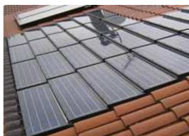
Intégration de Tuiles solaires sur une toiture
