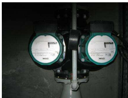
Pompe double réseau secondaire
