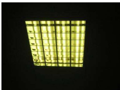
Eclairage de bureaux
