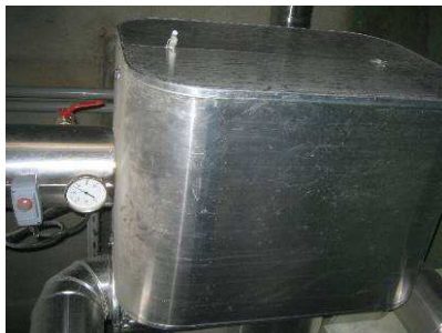
Echangeur chauffage urbain
