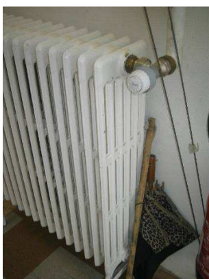
Radiateur dans le bâtiment 4
