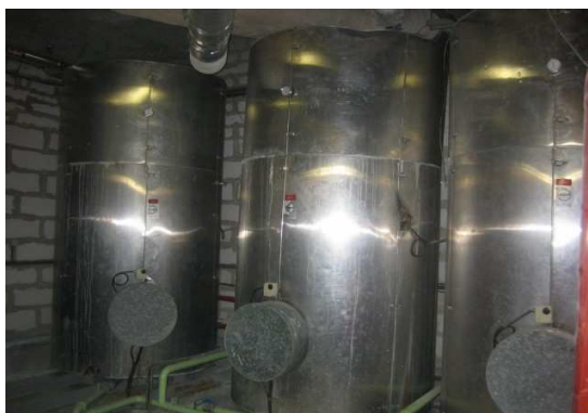
Ballons eau chaude cuisines
