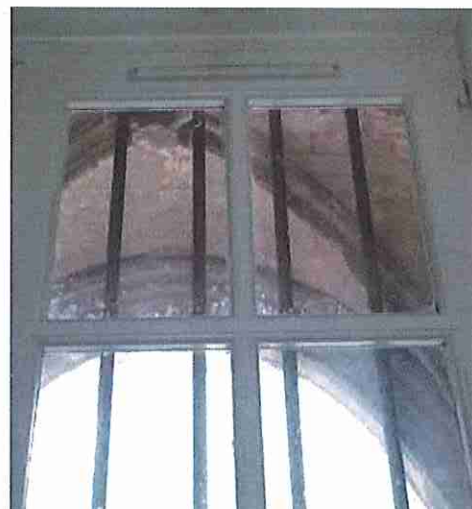
L'une des rares entrées d'air installées
