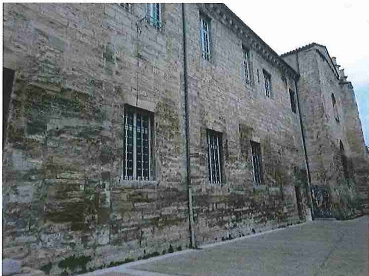
Remontées capillaires externes
