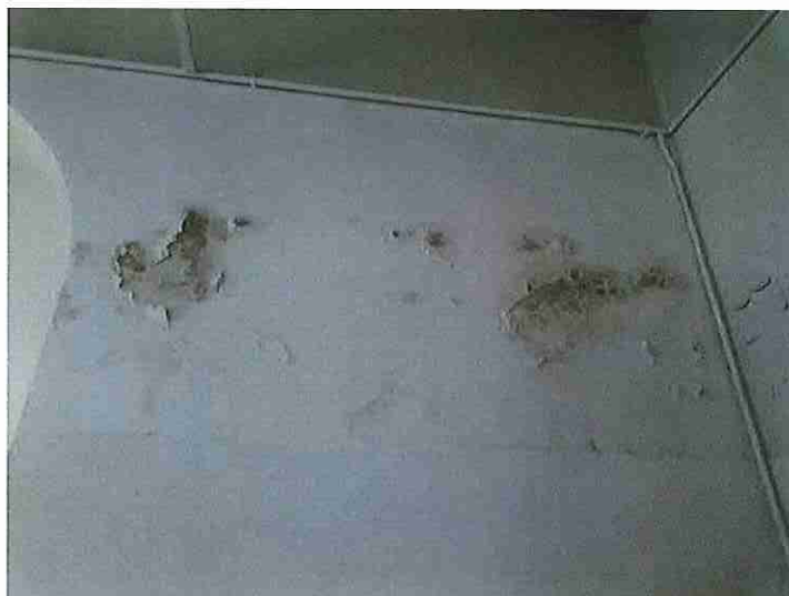
Remontées capillaires internes
