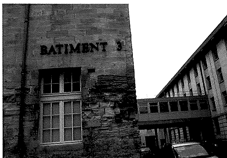
Importantes dégradations sur la façade du bâtiment
