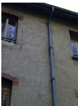
1/ Fissurations visibles en façade
