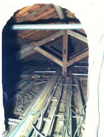
5/ Plancher bois et rampants de toiture non isolés
