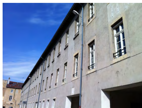
8/ Développement de mousses en façades
