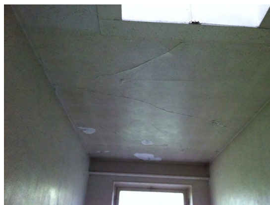
14/ Peinture de cage d'escalier craquelée
