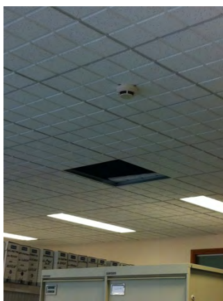
13/ Dalles de faux plafond manquantes ou à remplacer
