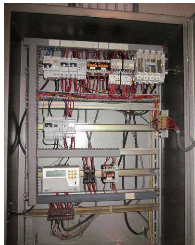
Fig. 4- Coffret électrique sous station
