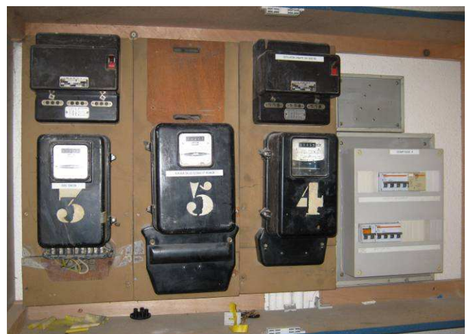
Fig. 10- Compteur et tableau électrique
