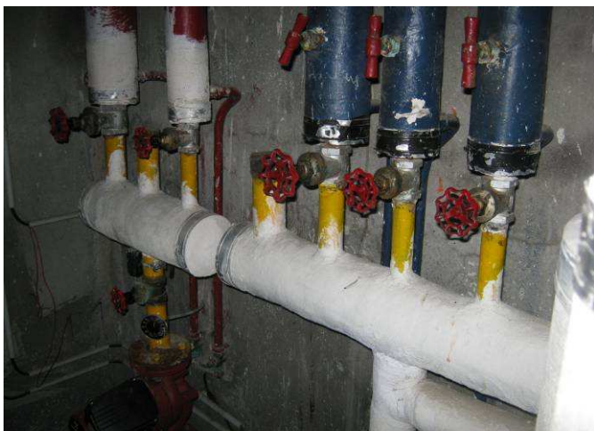
Fig. 11- Vannes sur réseau de chaleur
